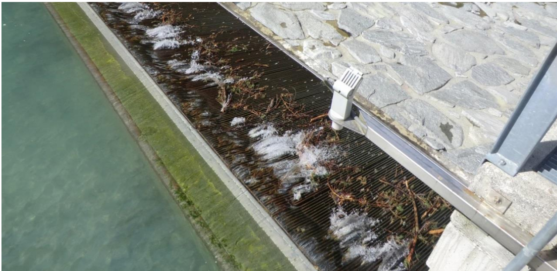
Figura 24: Misuratore di livello ad ultrasuoni montato su apposito supporto.
